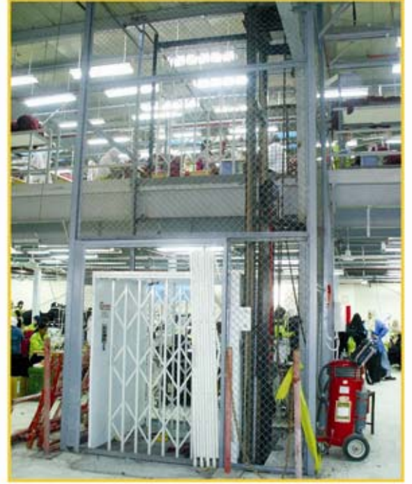
كابينة بضائع كبيرة داخل المصانع. Large cabin to lift goods in factories.
